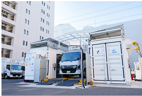
コンビニ向けバッテリー交換ステーション
