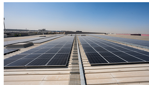
いすゞ自動車インターナショナル（IIF）の太陽光発電設備
